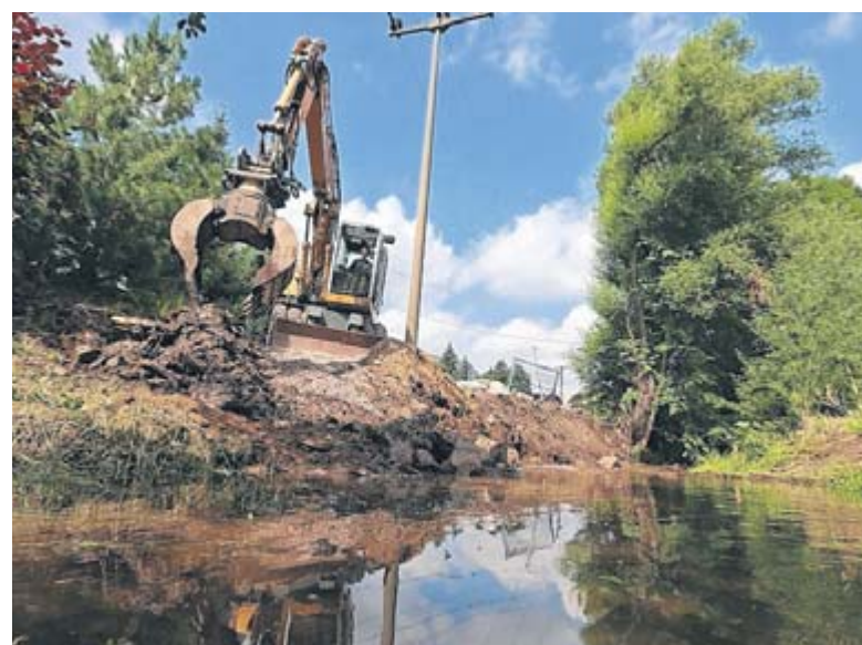
Am Langenberger Bach in Langenchursdorf sind derzeit Baumaschinen im Einsatz, um die Böschungen instand zu setzen. FOTO: ANDREAS KRETSCHEL
